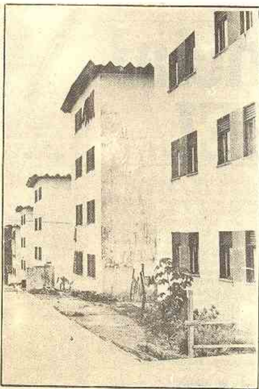
Nos conjuntos ainda falta infra-estrutura
