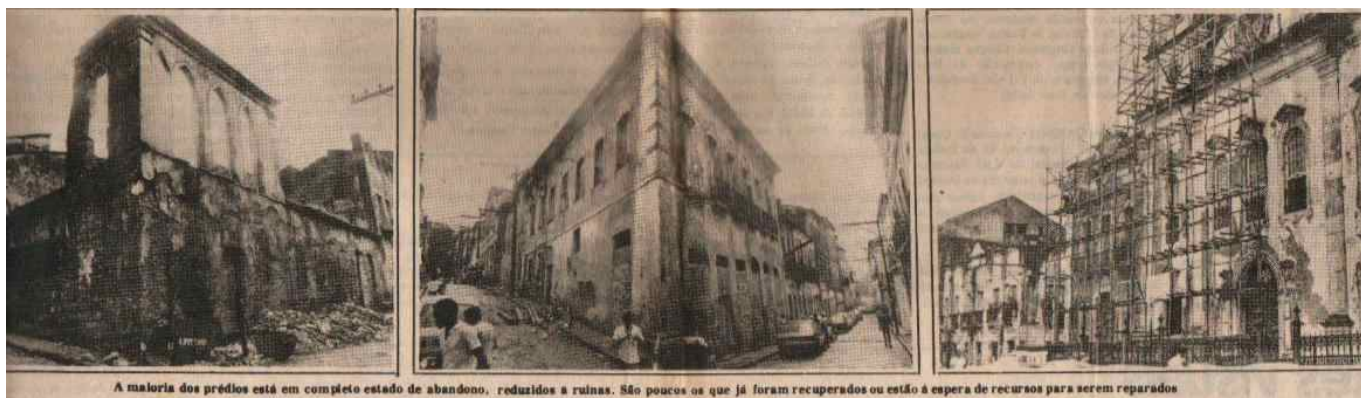
A maioria dos prédios está em completo estado de abandono, reduzidos a ruínas. São poucos os que já foram recuperados ou estão à espera de recursos para serem reparados
