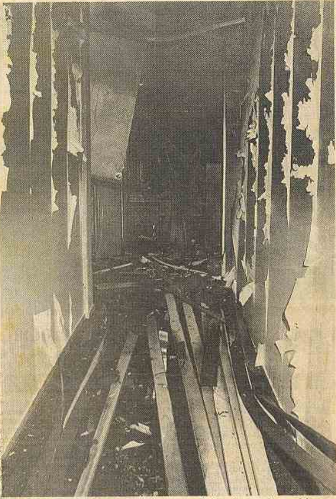
O fogo consumiu o mobiliário e esquadrias de um dos gabinetes
